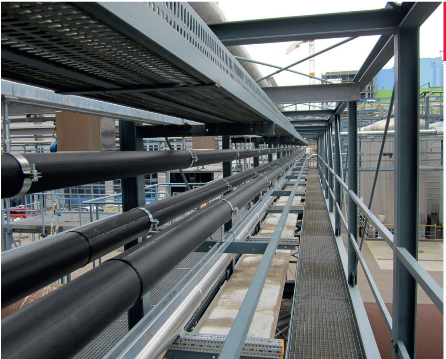
Kunststoffrohrleitungen auf Rohrbrücke
